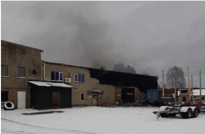
Bild 4: Verkstadsbyggnaden efter att explosion ägt rum
